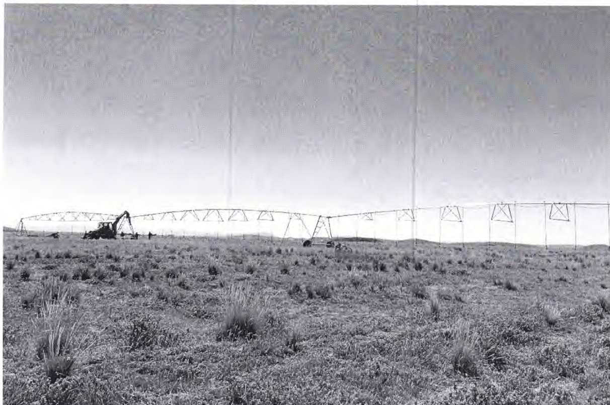
Figura 3. Instalación de riego tecnificado en el distrito de Mañazo.
